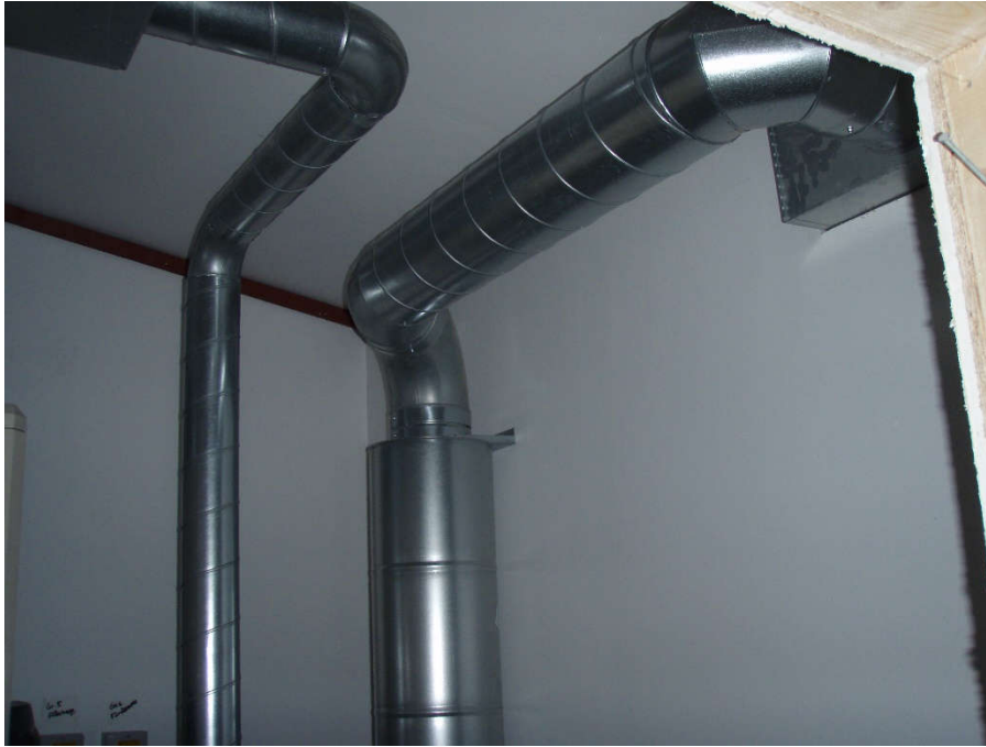
2015-02-13. Anslutningar till mötesrummet och datarummet
