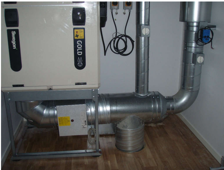
2015-02-13. Anslutningarna ner genom golvet går till kanaler på nedervåningen.
