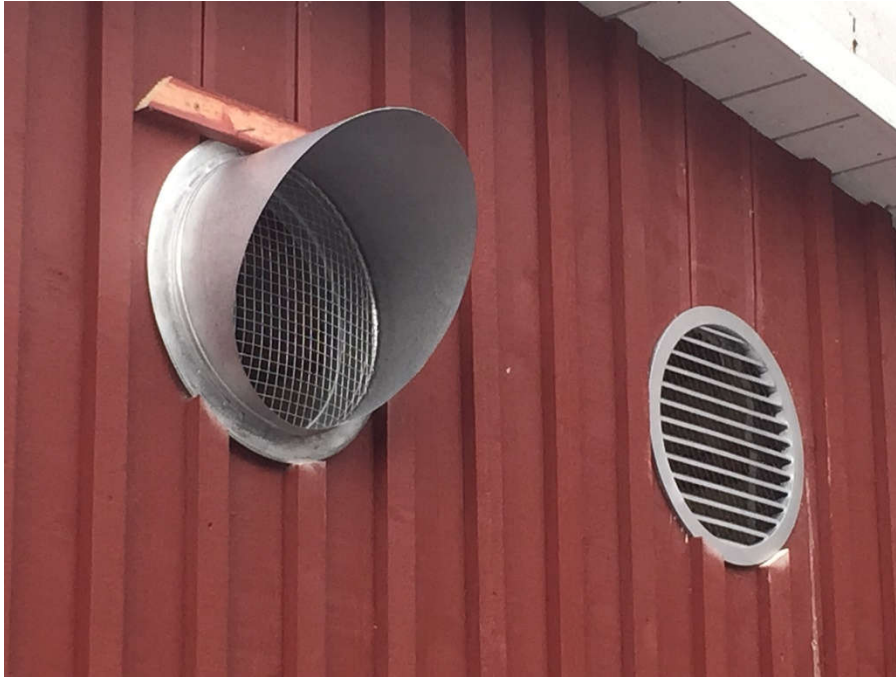
2015-04-04. Så här kommer det att se ut på utsidan när det är klart, avluftning till vänster och tilluft till höger
