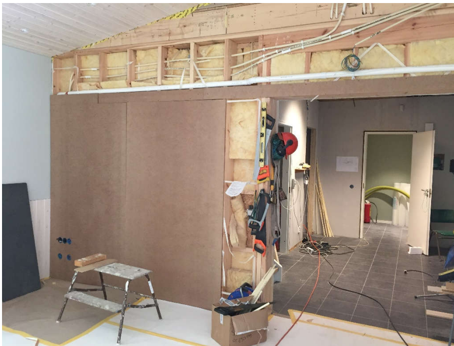
2015-10-06. Bokhyllorna på östra väggen i storstugan har påbörjats. Här återstår dock en del el-arbete innan det kan slutföras.
