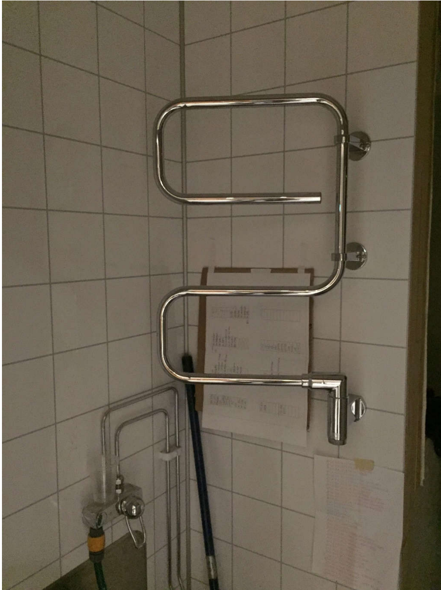
2016-02-10. I städskrubben har monterats larmanläggning med batteribackup. På bilden ser vi också handdukstorkaren på plats.
