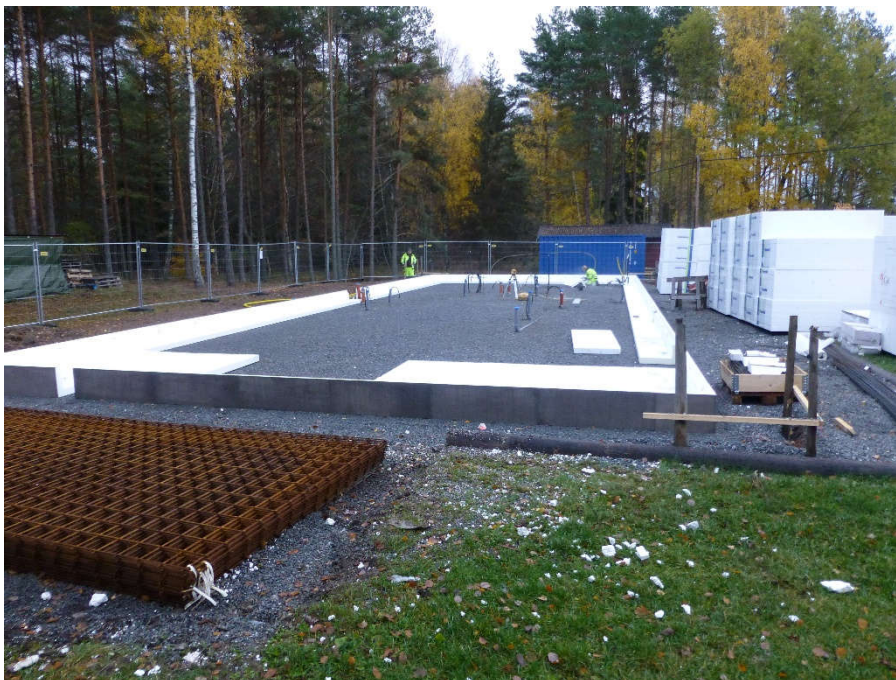
2013-10-24 08.25. Avloppsrören under plattan och kantelementen är på plats. Isolering med frigolitskivor pågår. Isoleringsskiktet blir 30 cm tjockt under större delen av plattan.
