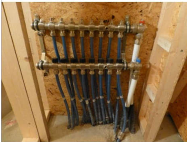
Fördelaren för golvvärmerören till entréhall, storstuga och kök sitter i städrummet.
