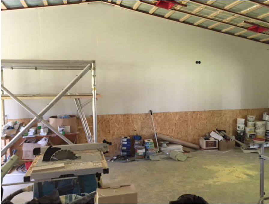
2015-06-07. Väggarna klara på norra, västra och södra sidan av storstugan. Väv på plats och målning påbörjad.
