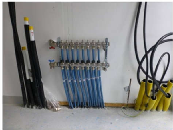
Fördelaren för golvvärmerören till omklädningsrummen och handikapptoaletten sitter iteknikrummet.
