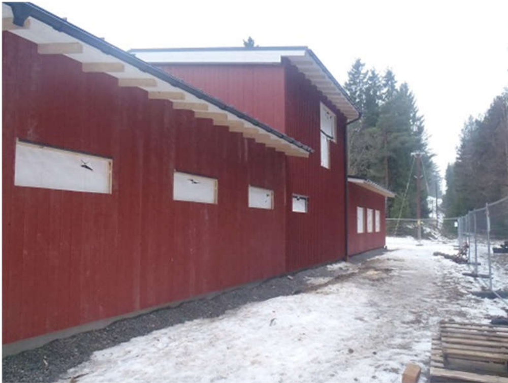
2014-02-04. Byggställningen monterades ner idag och här ser vi också att ståldörren till teknikrummet kommit på plats
