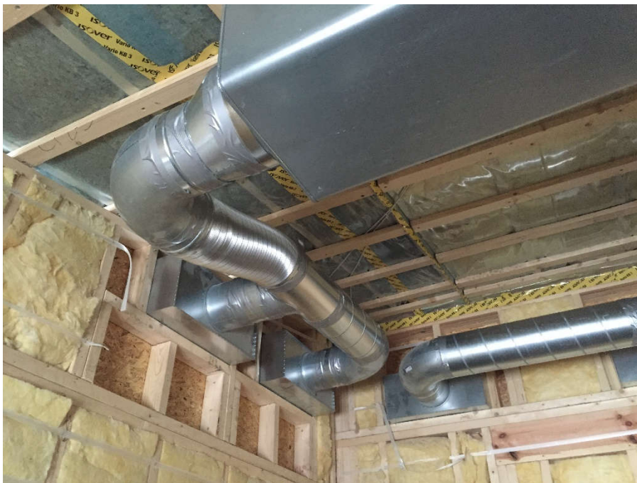
2015-02-02. Ventilationstrummorna i köket för tilluft i storstugan monterade och klara!
