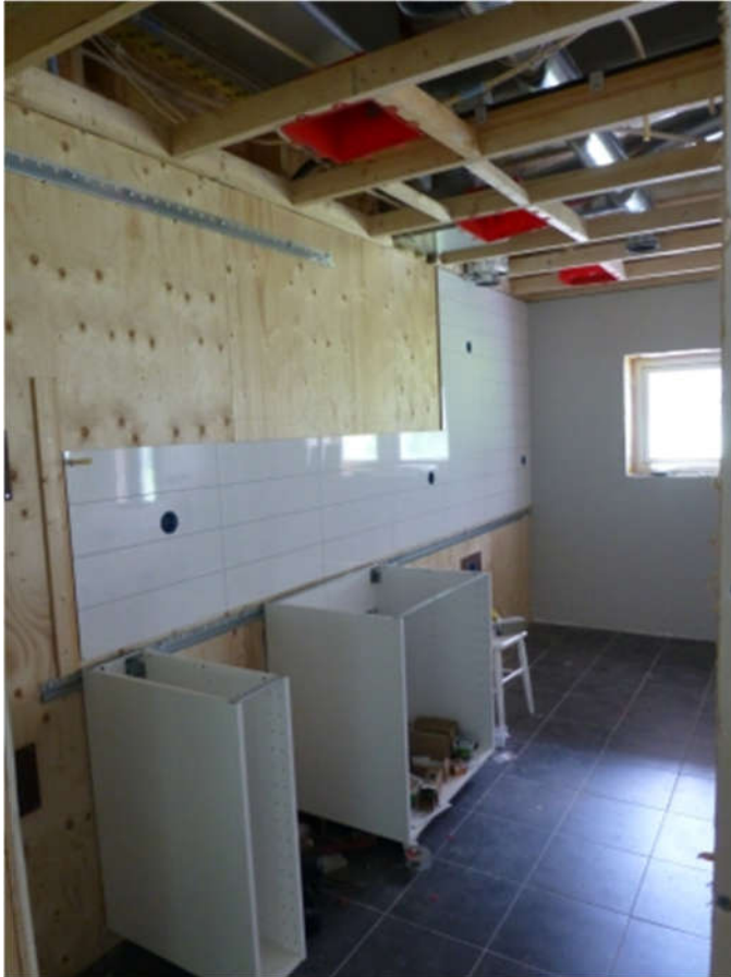
2015-07-12. Väggskivor (Fibo-Trespo) på ytor i köket som ej skall täckas av skåp börjar komma på plats.
