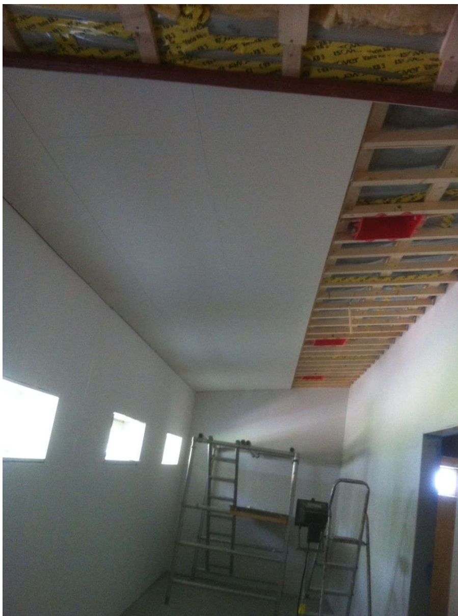
2014-07-02. Montering av takskivor har startat. Dessa har B-O och Uffe satt upp i herrarnas omklädningsrum
